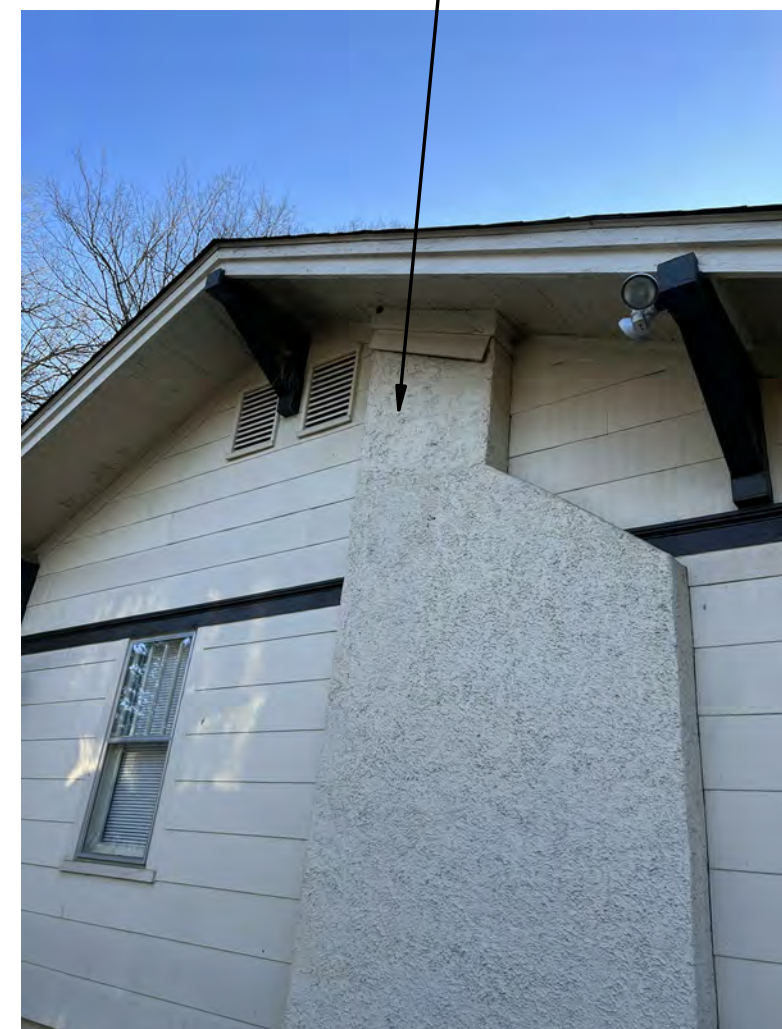
LEFT SIDE CHIMNEY
